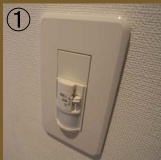
【玄関照明オートスイッチ】
